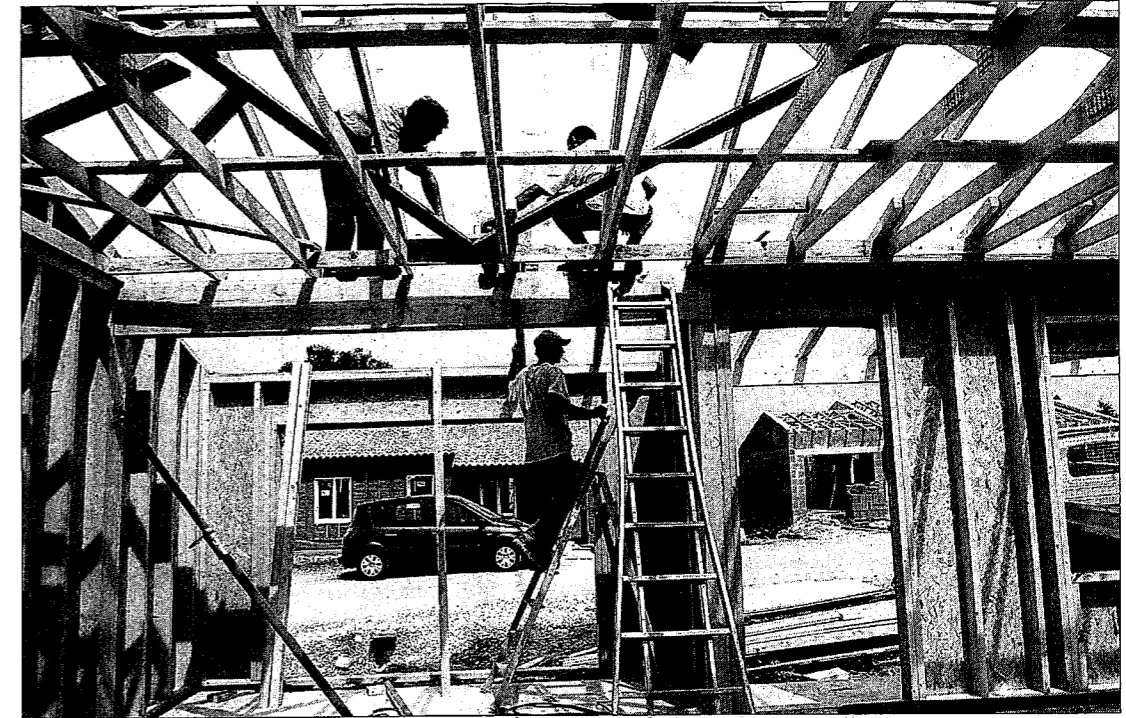
Vingt maisons à ossature bois déjà vendues sont en cours de construction dans le hameau des Pins, du T2 de 52 m 2 au T4 de 88 m 2 : un chantier de référence également pour l'entreprise celloise Pougnaud, qui réalise toutes les maisons.
